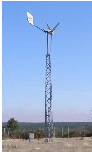
Figura 8. Aerogenerador de Windeco (Fuente: CIEMAT)
