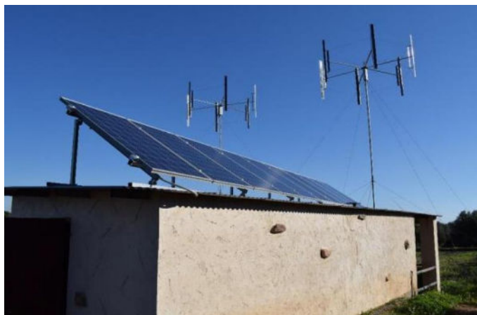
Figura 10. Aerogeneradores de Baiwind en el proyecto LIFE COOP 2020 [40]
