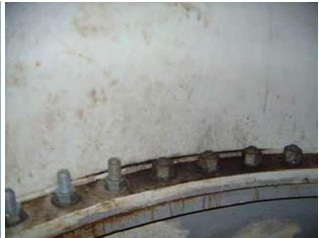
Grieta en la soldadura de la brida a la torre
